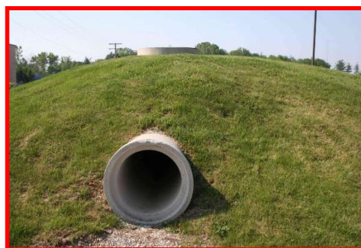
Đường ống thông hơi
